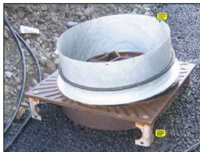
TOPPLATE PÅMONTERT SØTTEBEN (IKKE ORIGINAL)
