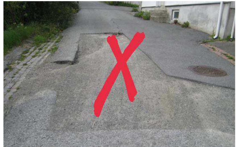
Feil utført skjæring.
