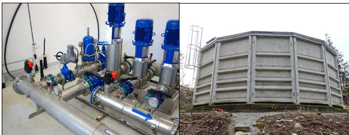
Bilde 2.3. Trykkøkingspumper Kleivane og høydebasseng Bergebakkane
