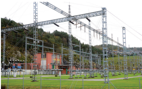
Transformatorstasjonen ved Tronsholen.
