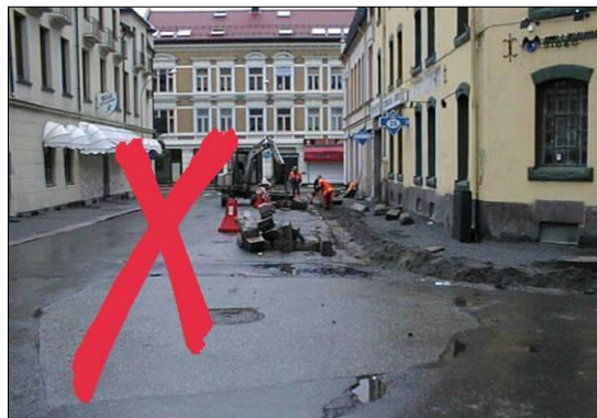
Manglende skilting og sperring.
